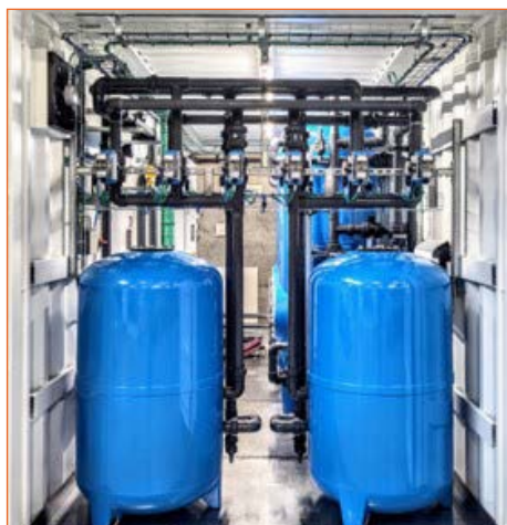
Bild 3: Ansicht der Filter innerhalb des Containers
