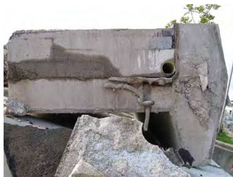
Bild 32: Alter Deckaufbau; zu erkennen ist eine stark durchfeuchtete Porenbetonschicht über dem Tragbeton und eine mangelhafte Abdichtung, die bereits mit einer Drainage und Tropfzuleitung nachgerüstet wurde
