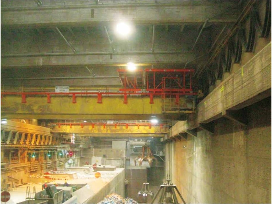
Bild 11: Kranplattformen in Parkposition auf einem Abfallkran im Abfallumschlagbetrieb
