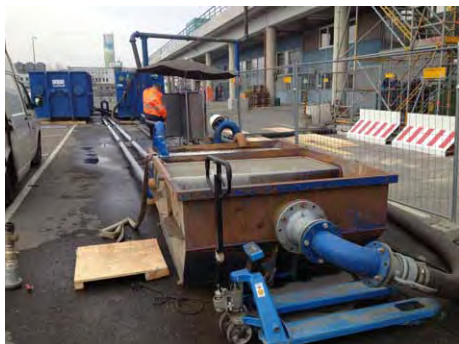
Bild 53: Wasseraufbereitungsanlage für HDW-Arbeiten mit Absetzbecken für Feststoffe und Neutralisationsanlage für den pH-Wert. Die Anlage konnte Spitzen beim Abwasseranfall puffern und eine kontinuierliche Einleitung in den Schmutzwasserkanal am Standort zu den Einleitbedingungen der Wasserbetriebe gewährleisten
