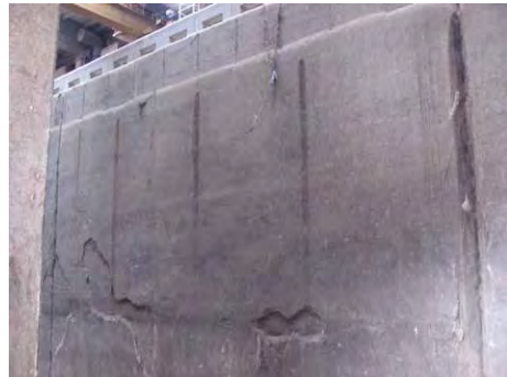
Bild 46: Großflächige Abplatzungen des Betons infolge Greiferanprall
