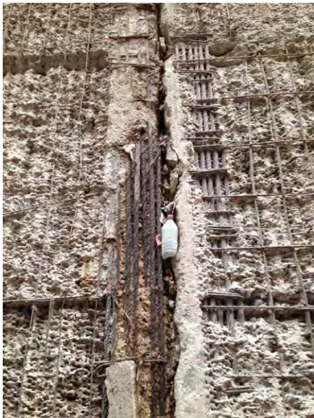
Bild 45: Schaden mit Betonstahlkorrosion an einer Gebäudefuge
